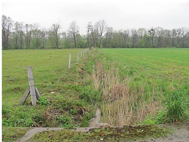
Fot. 76. Rów melioracyjny w złym stanie technicznym – obręb Dziewiętin
