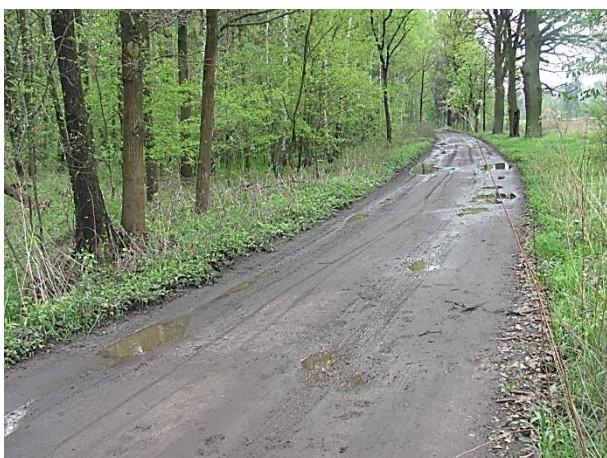
Fot. 80. Droga gminna wymagająca przebudowy – obręb Brzostowo
