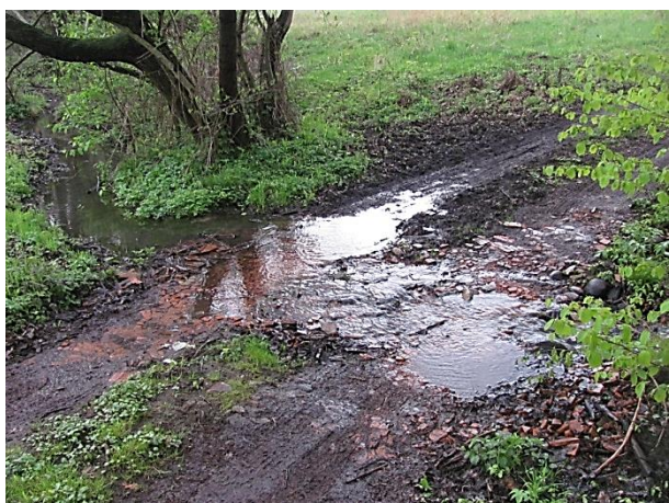
Fot. 34. Brak przepustu pod drogą (dz.226) - obręb Świebodów
