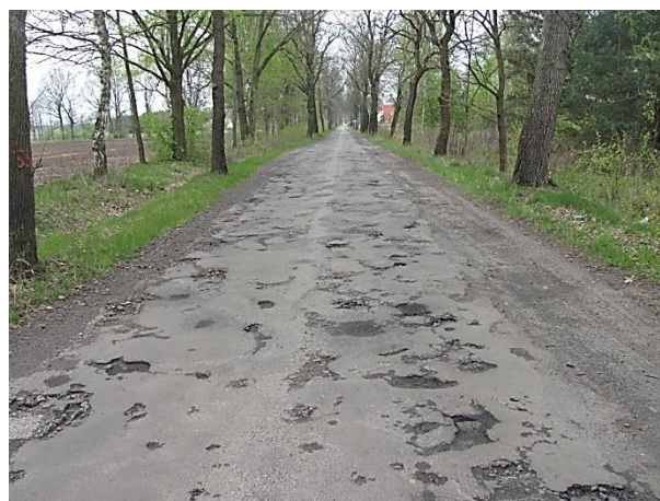
Fot. 81. Droga powiatowa wymagająca przebudowy – obręb Grabownica
