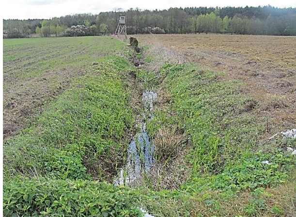
Fot. 78. Rów melioracyjny w złym stanie technicznym – obręb Bukowice
