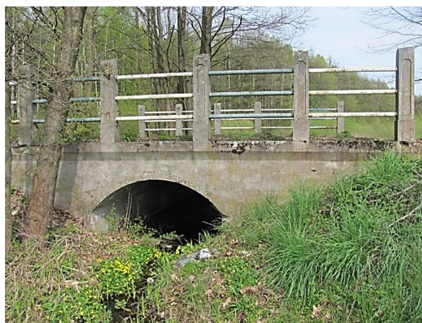
Fot. 35. Rów wymagający konserwacji (dz.24) - obręb Bukowice
