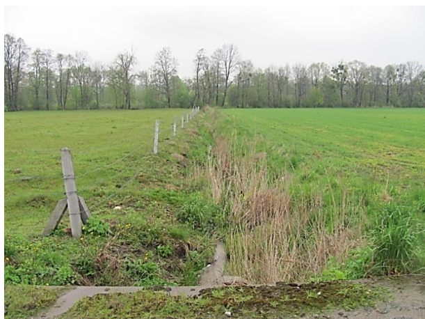
Fot. 76. Rów melioracyjny w złym stanie technicznym – obręb Dziewiętlin
